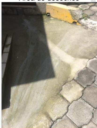
Conexión de área de desechos a cisterna de agua contaminadas
