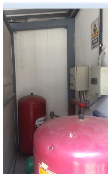
Bomba de agua y bomba de equipo contra incendio
