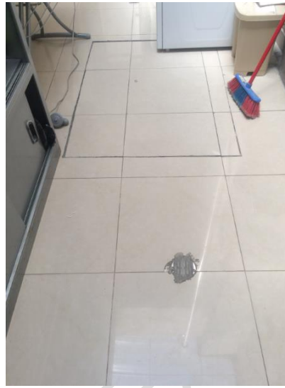
Caja de revisión en el área de lavandería
