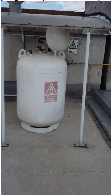
Almacenamiento de GLP
